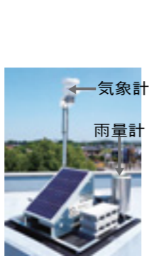
▲市役所屋上に設置したPOTEKA
